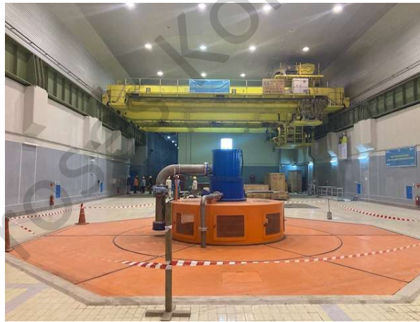
Foto 38: Interior rumah pembangkit tenaga listrik
