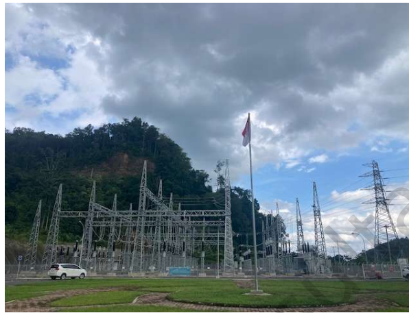
Foto 35: Gardu induk di sebelah gedung kontrol
