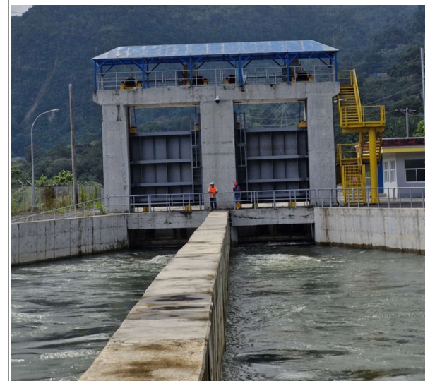
Foto 66: Pintu air pembilasan pasir di hulu kolam
